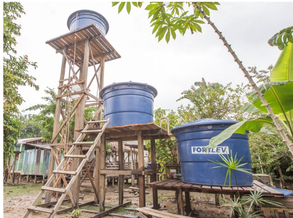
Disposição dos Reservatórios Elevados. Fonte: Memorial Chico Mendes
